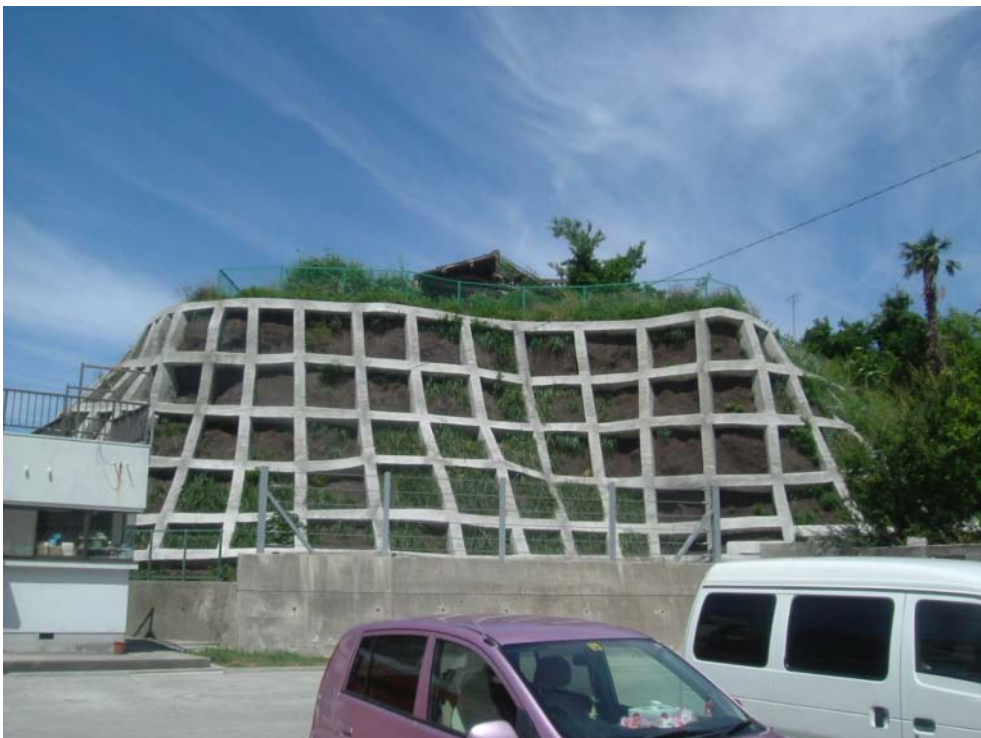
洲本市福良(2)地区 復旧後の状況。法枠を施工し、斜面を保護している。
