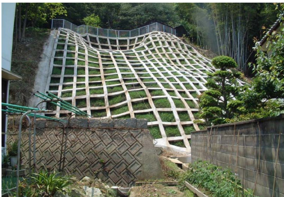
洲本市物部(2)地区 復旧後の状況。法枠を施工し、斜面を保護している。
