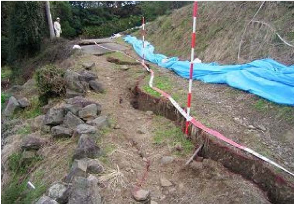
南あわじ市灘城方(2)地区 台風 23 号の降雨により発生した滑落崖
