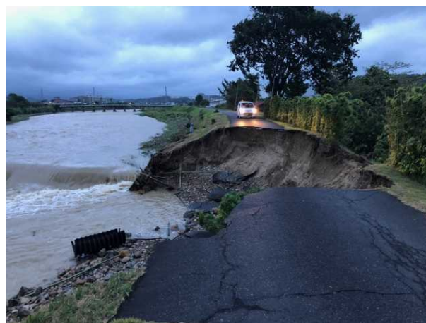
有馬川護岸欠損
