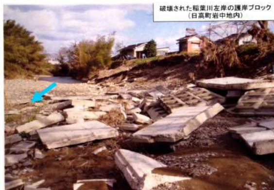
【平成 16 年台風 23 号時の稲葉川の被災状況】
