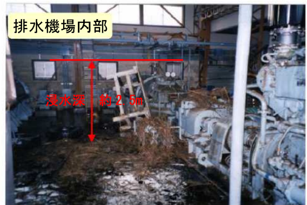
【平成 16 年台風 23 号時の六方川排水機場内部被災状況】
