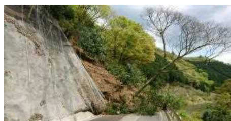
道路区域上部の民有地の崩壊（H29.4 養父市）
