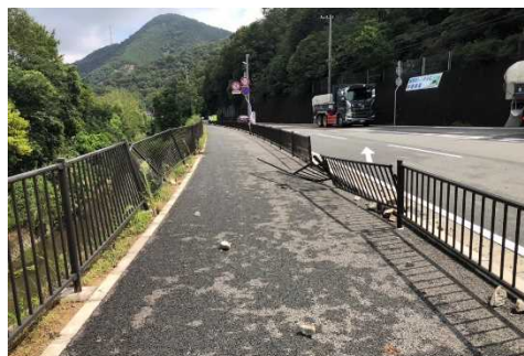
既存施設を越える落石の発生 (R3.9 赤穂市)
