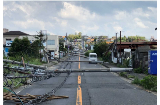
図 2.2 倒壊した電柱による道路閉塞 (平成 30 年台風 21 号 大阪府泉南市)
