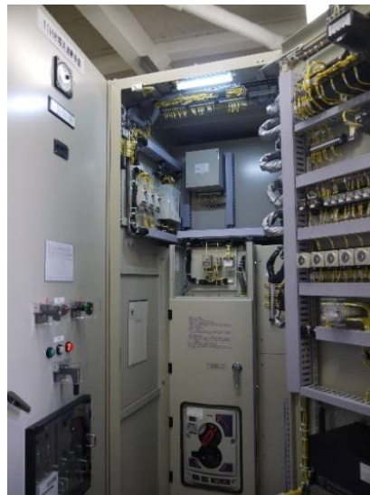
図 4-59 変電設備の更新（京都丹後鉄道）
