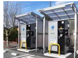
充電施設 蓄電池
