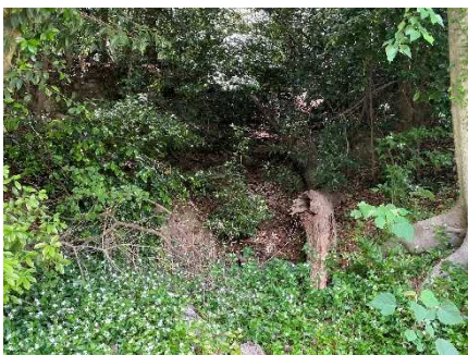
②斜面状況
