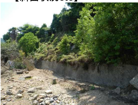
②斜面状況
