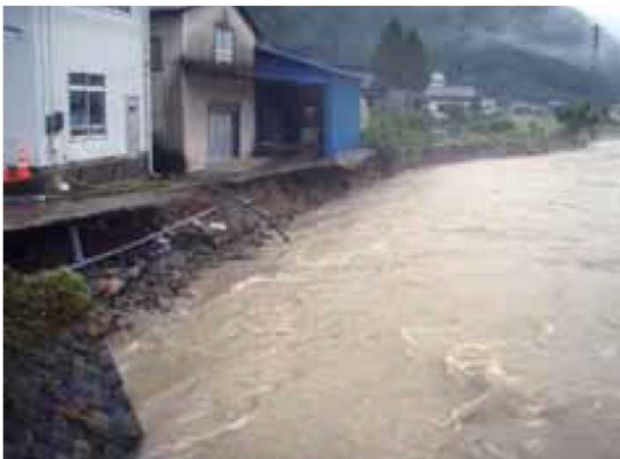
引原川：被災状況(宍粟市安積町)
