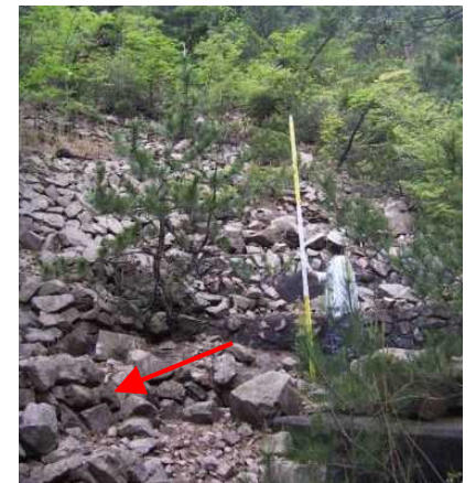
溪流荒廃状況
