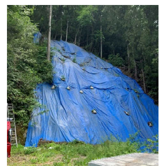
④斜面荒廃状況
