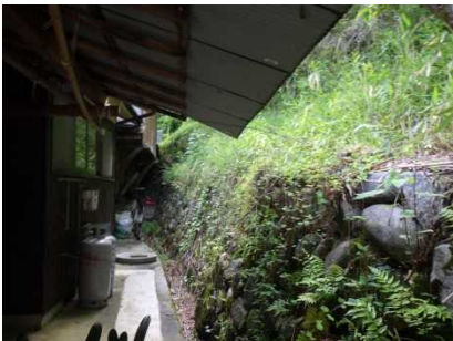
②斜面状況(人家裏)
