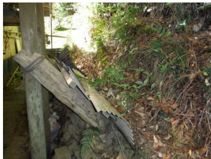
③斜面崩壊状況
