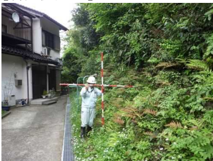
②斜面状況(人家裏)
