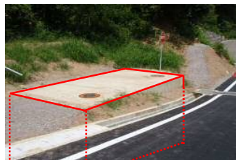
地下埋設型防火水槽
