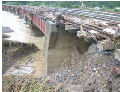
第1佐用橋梁 被災状況
