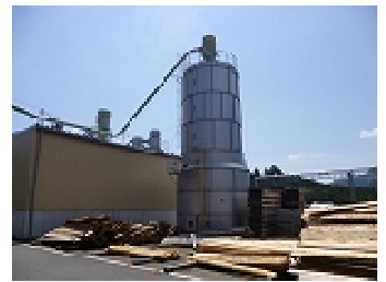
バイオマスボイラー関連施設
