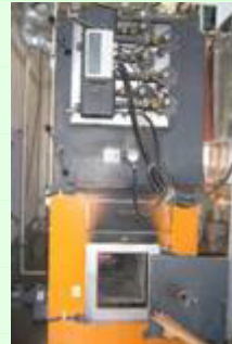
チップボイラー
