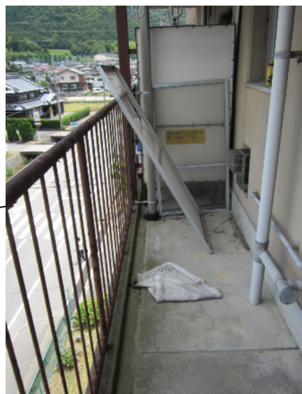
外部：手狭で防災上不安全なバルコニー
