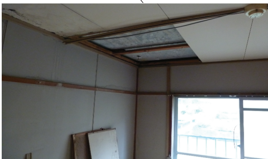
内部：天井の劣化
