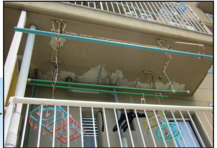
コンクリート剥離状況
