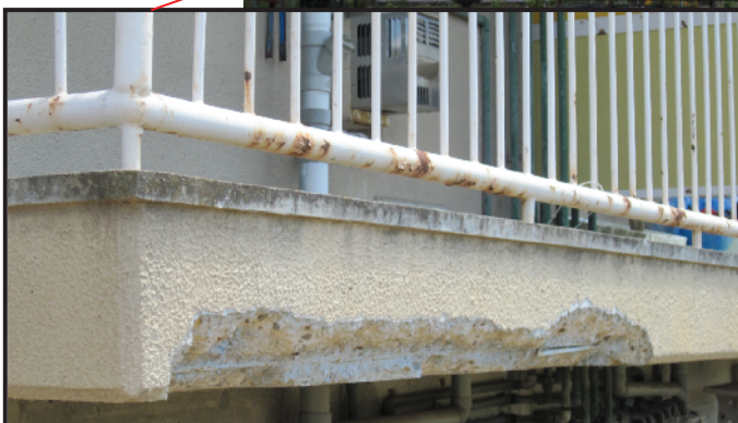
コンクリート剥離状況
