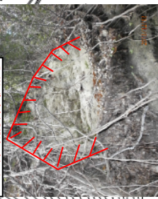
法面崩落状況
