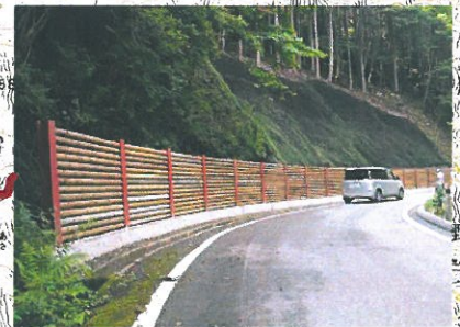
県内産間伐材利用(落石防護壁)
