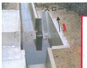
■スロープ付き集水ます
