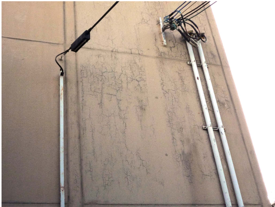
伊丹野間鉄筋住宅現状写真 外部：表面上のひび割れ
