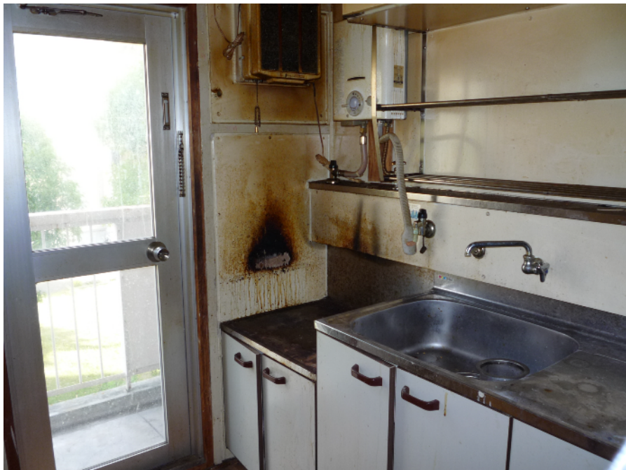
伊丹野間鉄筋住宅現状写真 内部：台所付近（コンロ台及び壁面の補修困難）
