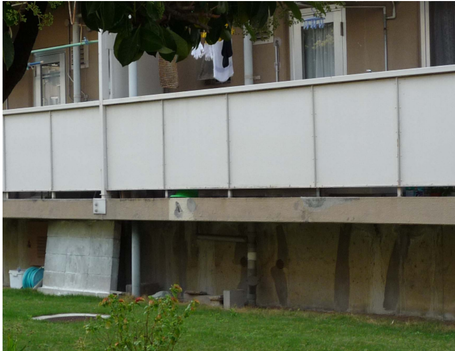
伊丹野間鉄筋住宅現状写真 外部：コンクリート剥離
