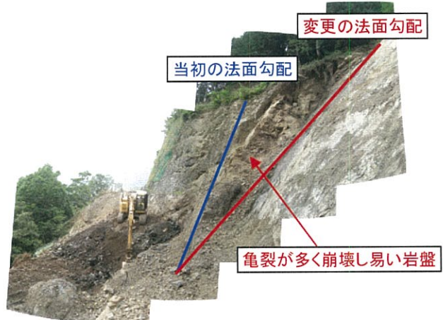
⑥ 脆弱な地質 亀裂の多い岩盤
