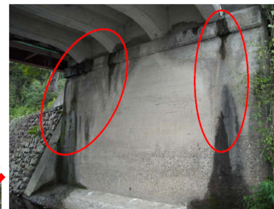
橋台のひびわれ、漏水の状況
