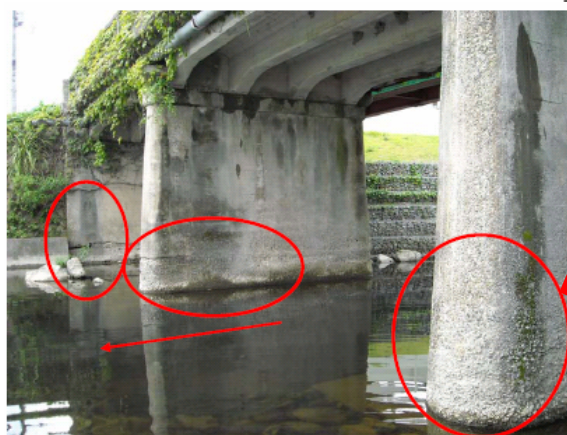
橋脚コンクリートの剥離と露筋の状況
