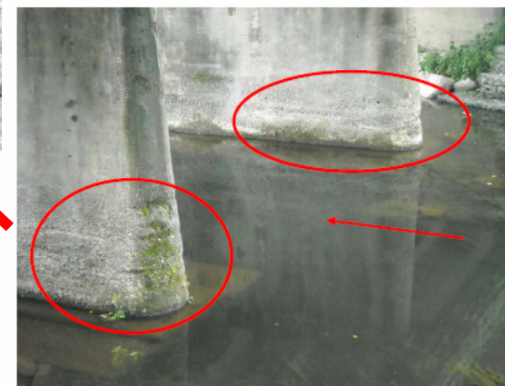
橋脚コンクリートの剥離とひびわれの状況
