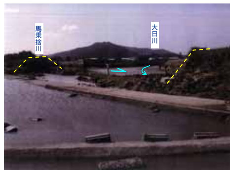
大日川、馬乗捨川合流部破堤
