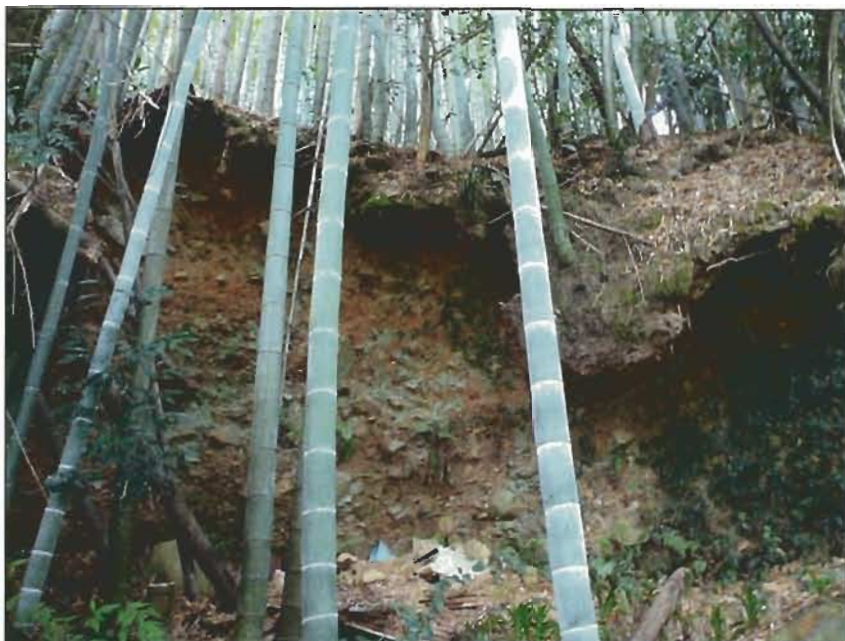
①斜面荒廃状況
