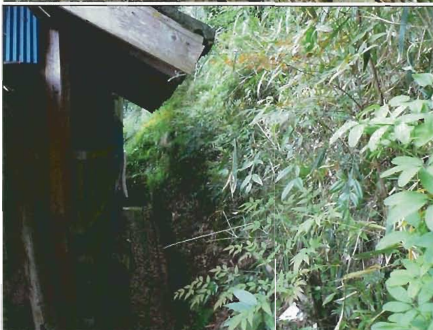
③斜面状況
