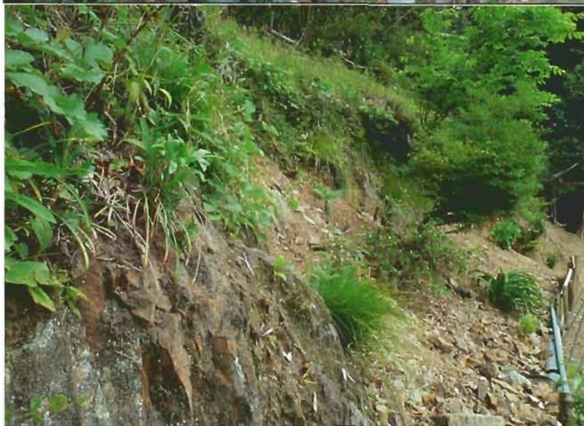
②H18年7月豪雨による斜面崩壊状況
