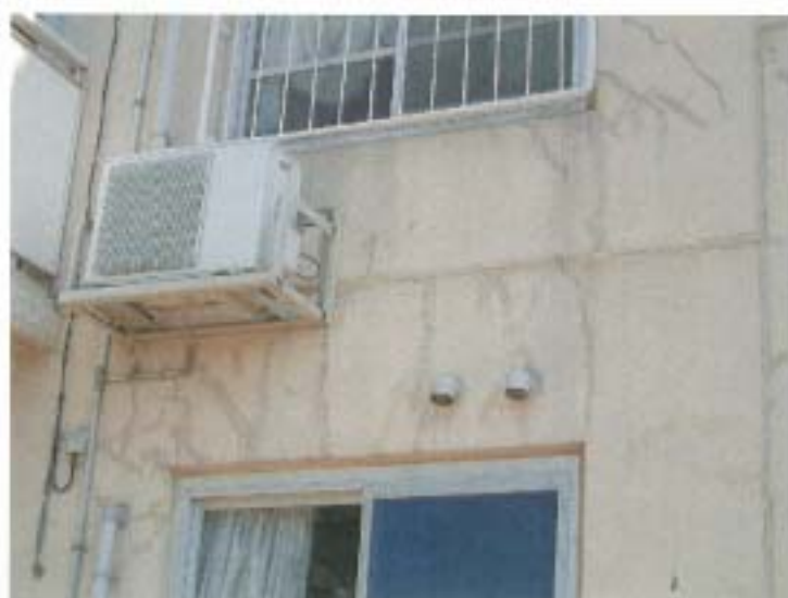
伊丹小松原鉄筋団地現状写真 外部：外壁コンクリート剥離
