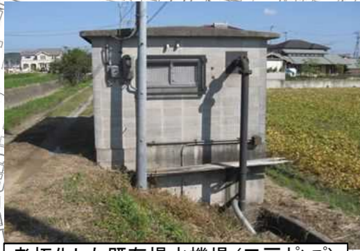
老朽化した既存揚水機場(口戸ポンプ) → 他排水機場と統合して廃止
