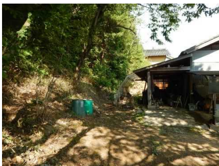
②斜面状況(人家裏)
