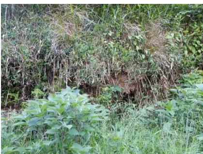
②斜面状況(人家裏)
