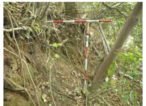
③斜面状況
