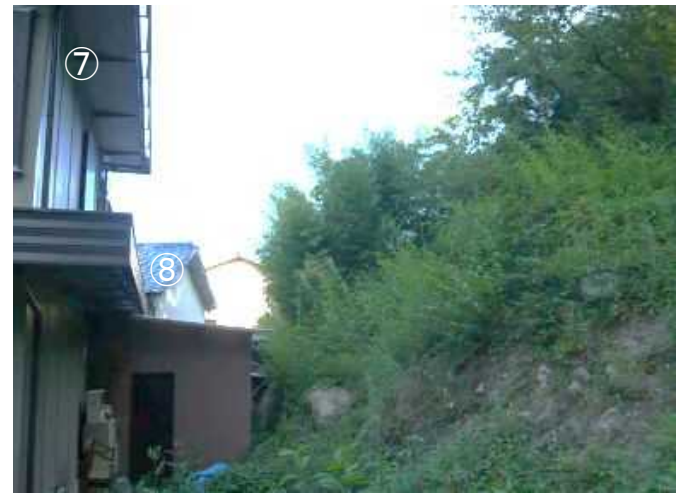
斜面と保全対象の関係 がけ直下に保全対象人家がある
