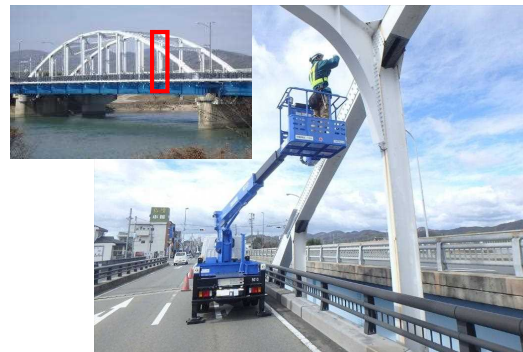
県管理橋梁の近接目視による点検状況 (国道 250 号 網干大橋)
