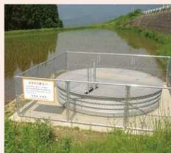
地すべり対策のための集水井(香美町口大谷)
