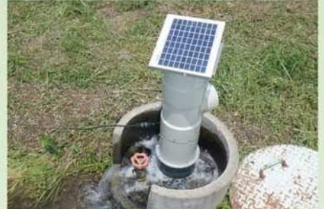
遠隔操作型自動給水栓による灌漑 (たつの市金剛山地区)
