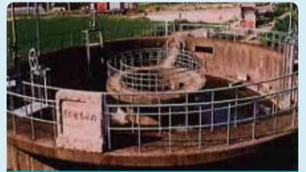
分水工：水を決められた量に分ける施設
