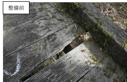
老朽化した園路
