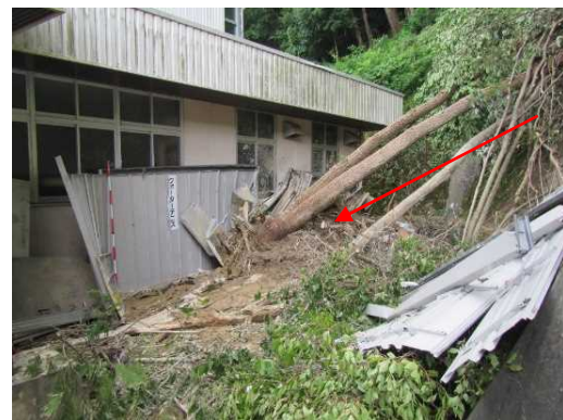
被災した体育館の状況
