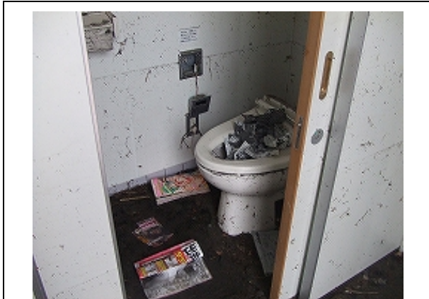
津波の泥に埋まったトイレ（釜石市）*1
