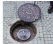
下水直結式仮設トイレ用マンホール
