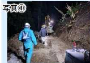
国道38号被災状況
