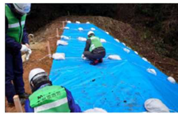
被災ため池におけるブルーシートの設置
