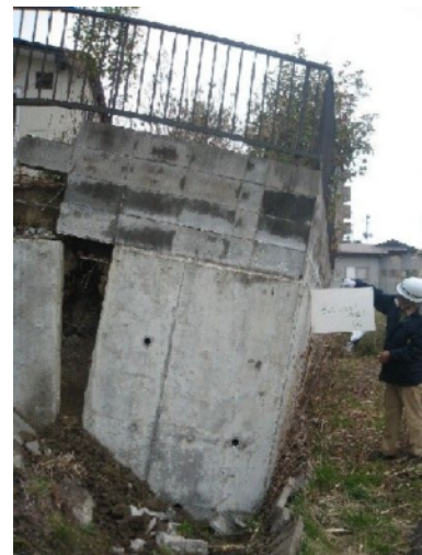
R C 擁壁の倒壊
