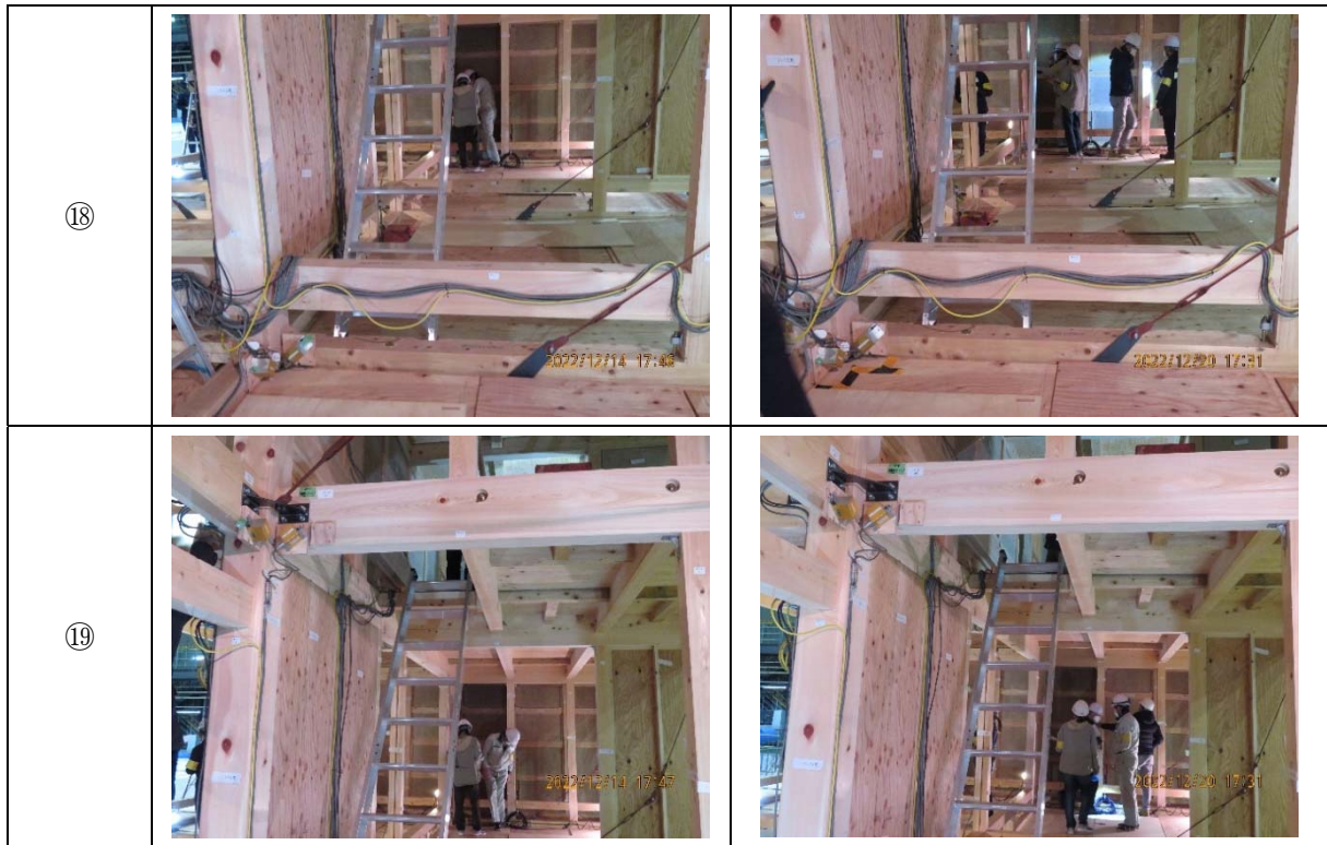
図 5-39 「り通り」(X8 構面) の損傷観察記録
