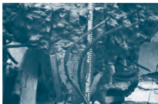
◆倒壊した中学校の柱の断面
