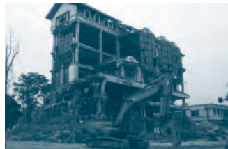
◆商店街にあるビルの倒壊
