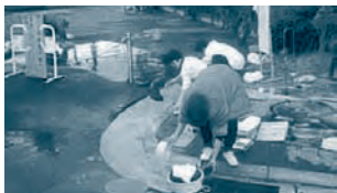
◆水道管破損箇所です水をくむ人々
