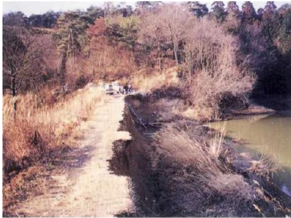
写真 1 二六池の被災状況
