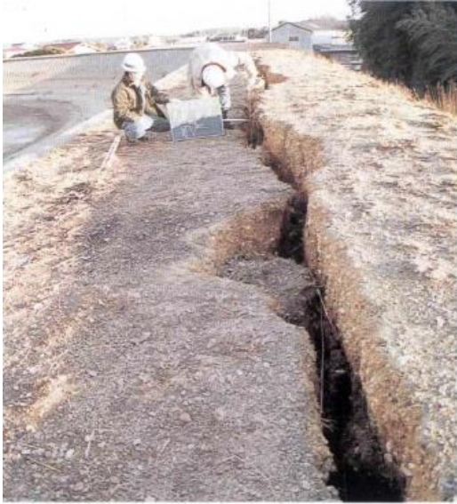
写真2 小鳥喰池の被災状況
