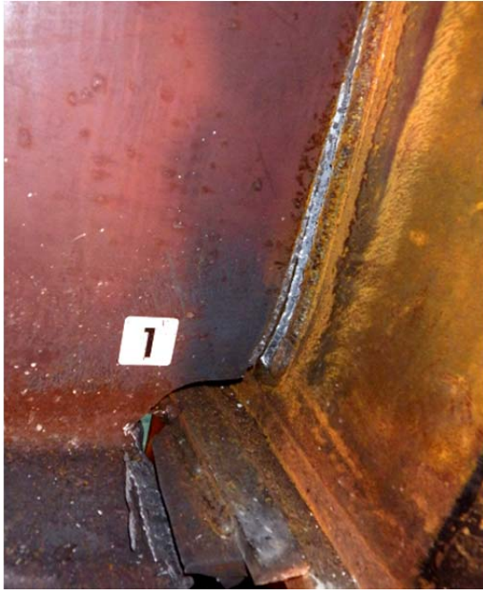
(a) 2階①側柱梁接合部
