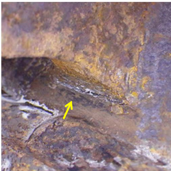
(e) 2階中柱梁接合部
