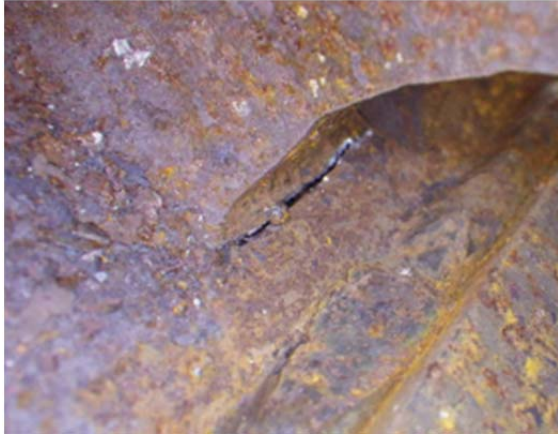
(a) 下フランジスカラップ底の亀裂
