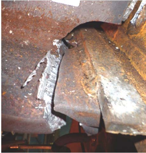
(a) 2階①側柱梁接合部
