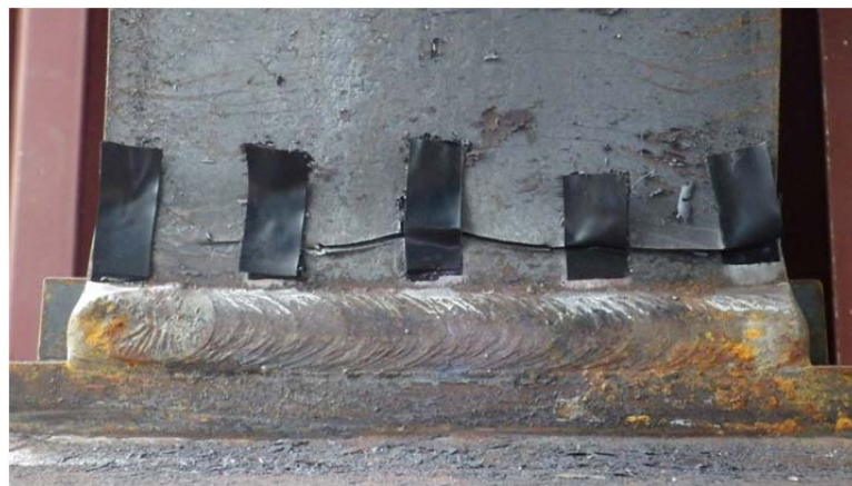
図 4.3 梁端下フランジの延性破断
