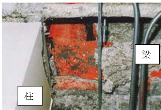
写真 CB1.6.1 下フランジの局部座屈と破断
