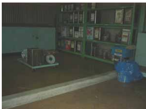
油類が外部にもれるのを防ぐ「防液堤」
